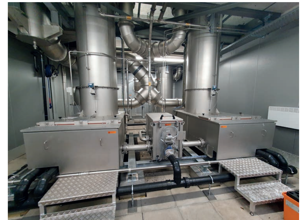
Die drei KMA-Gaswäscher kühlen, befeuchten und reinigen die Schokoladen-Abluft in Vorbereitung auf den Biofilter. (Bild: KMA) The three KMA gas scrubbers cool, humidify and clean the chocolate exhaust air in preparation for the biofilter. (Image: KMA)
