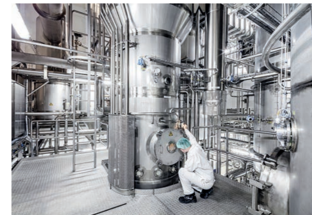
Die neue Verdampferanlage der Uelzena-Gruppe. (Bild: Uelzena) Uelzena Group's new evaporator plant. (Image: Uelzena)
