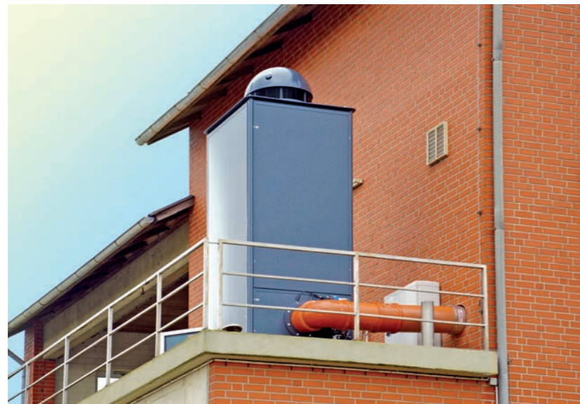
Übler Geruch zählt zu den häufigsten Beschwerdegründen – Filter sind die technische Antwort. Hier ist der stationäre Hochleistungsfilter Coalsi-Volumenmax auf einem Dach angebracht. (Bilder: Fritzmeier) Bad smell is one of the most common causes of complaints – filters are the technological answer. Shown here: the stationary high-performance filter Coalsi-Volumenmax on the roof of a building (Images: Fritzmeier)
